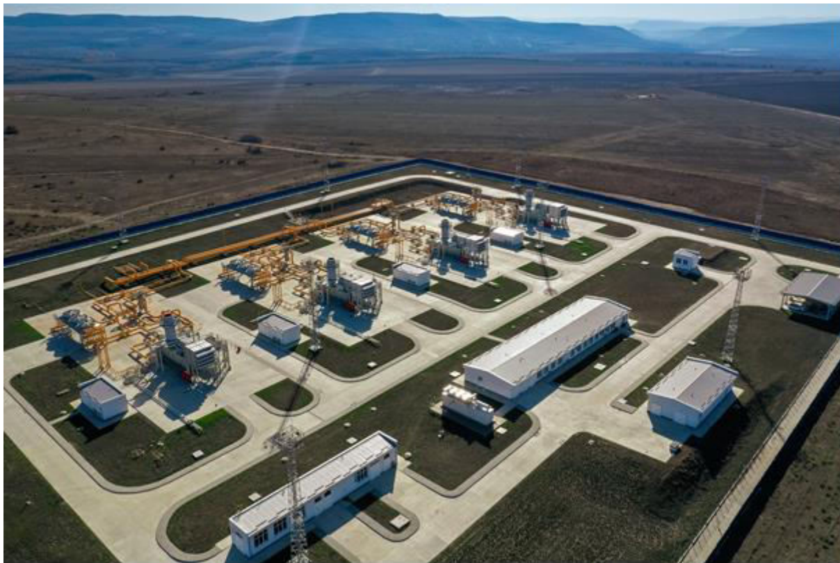
Компресорна станция „Нова Провадия“
