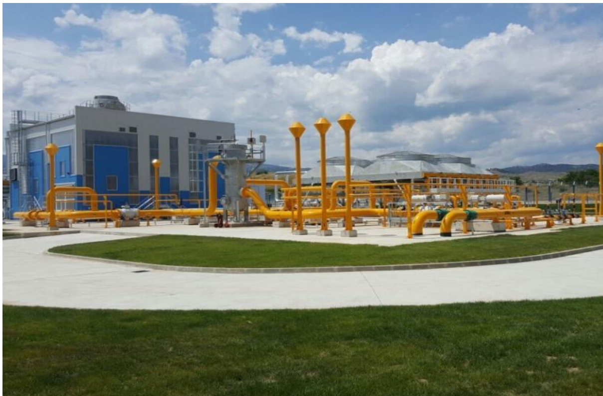
Компресорна станция „Ихтиман“
